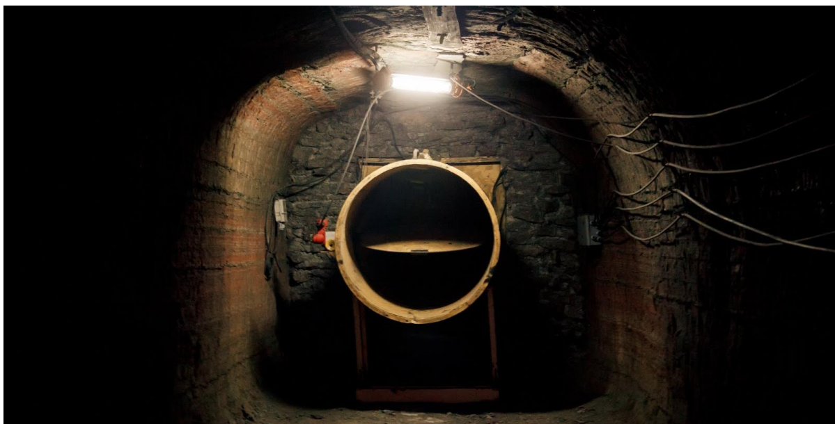
Рисунок 4.5 — Вентиляторная установка, смонтированная для организации рециркуляционного проветривания панели № 2 горизонта -440 рудника 4 РУ ОАО «Беларуськалий»
